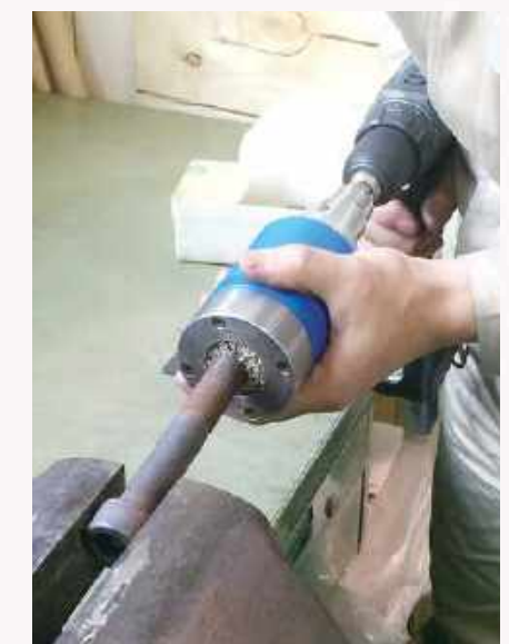
ボルトのサビを現場でスピード除去
